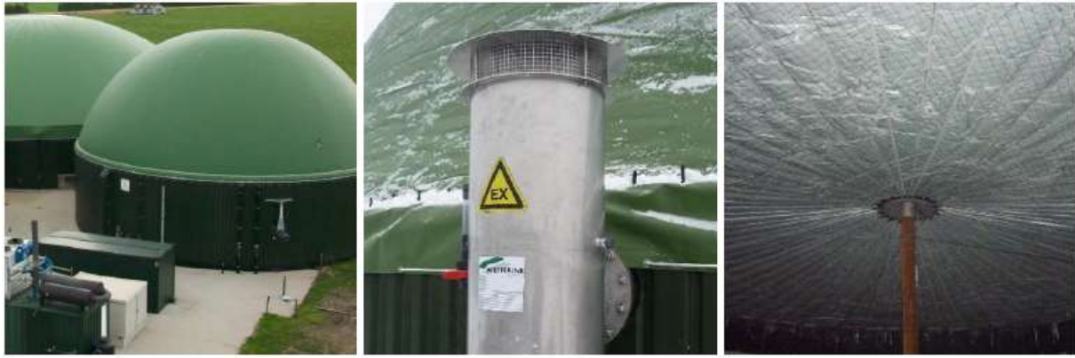
Rys. 4g. Zbiornik biogazu w postaci pokrycia dachowego tzw. membrany (rysunek z lewej). zawór bezpieczeństwa nadciśnienia gazu w zbiorniku (rysunek w środku); membrana z konstrukcją podtrzymującą wewnątrz zbiornika w postaci odpowiednich lin i siatki do zbierania siarki w procesie odsiarczania (rysunek z prawej).
