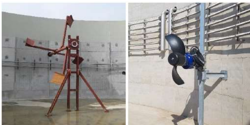
Rys. 4f. Mieszadła wewnątrz zbiornika.
