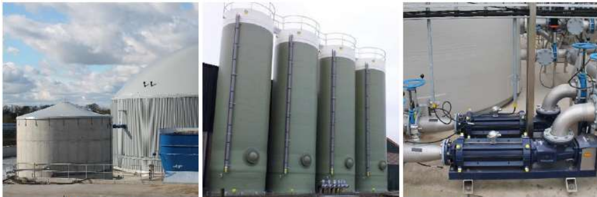
Rys. 4c. Zbiornik na płynne substraty- żelbetowy ten mniejszy (rysunek z lewej); zbiorniki magazynowe z tworzywa sztucznego na inne płynne substraty z króćcami przyłączenia na pojazdy dowożące substraty płynne (rysunek środkowy); pompy (rysunek z prawej).
