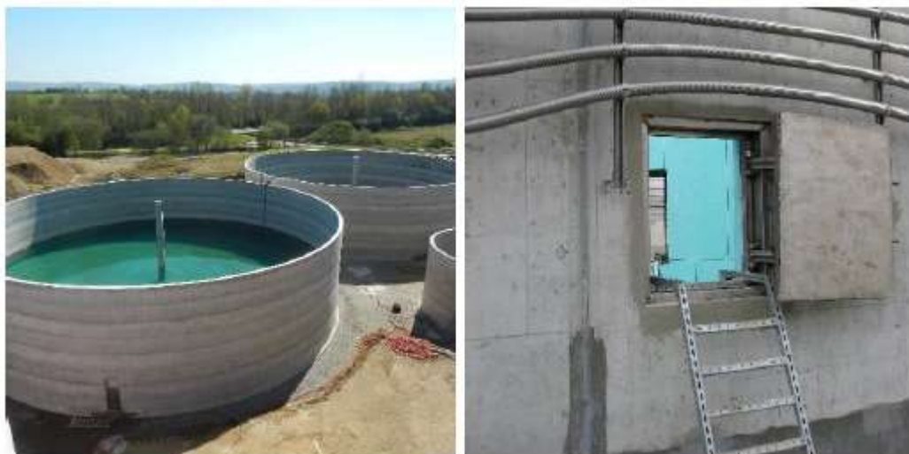
Rys. 4d. Żelbetowe zbiorniki nieuzbrojone w trakcie budowy (rysunek z lewej); właz technologiczny z systemem grzewczym zbiornika fermentacyjnego żelbetowego – widok od środka po wybudowaniu, przed wypełnieniem (rysunek z prawej).
